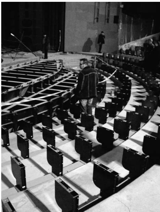
Montáž kresiel hľadisku nového sídla Slovenského národného divadla. Snímka archív Správy kultúrnych zariadení.
