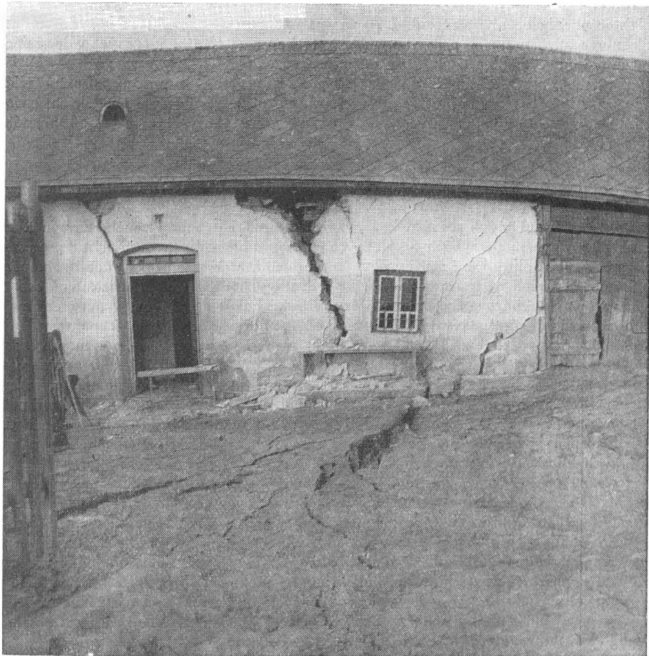
Obr. 7. Deformácia na obytnom dome.
